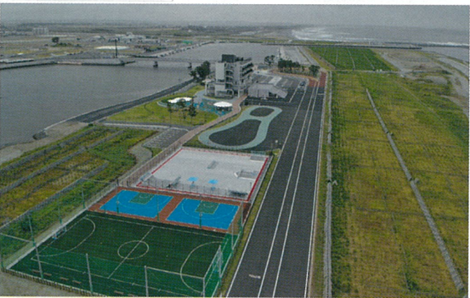
▲ 名取市サイクルスポーツセンター施設復旧工事（宮城県名取市）： 日建工業(株)
